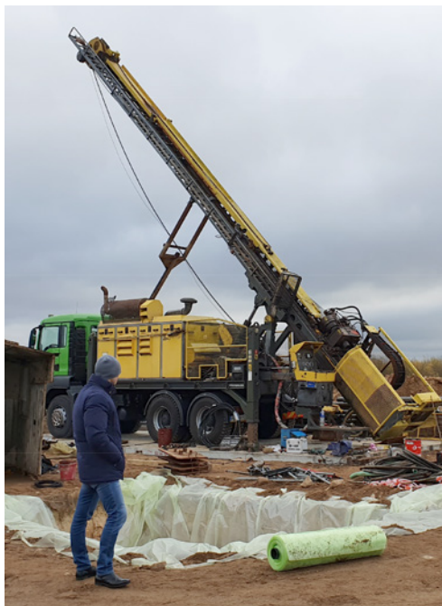
2 pav. Nuožulnaus gręžinio darbų aikštelė. A. Armanavičiaus ir UAB „GJ Magma“ nuotraukos
